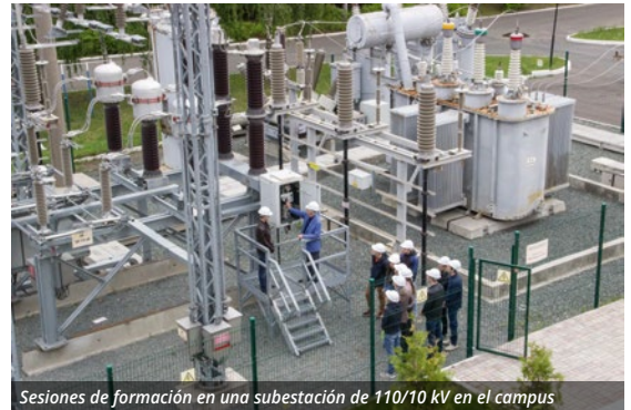
Secciones de formación en una subestación de 110/10 kV en el campus
