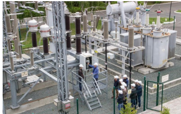
Учебные занятия на подстанции 110/10 кВ на территории кампуса
